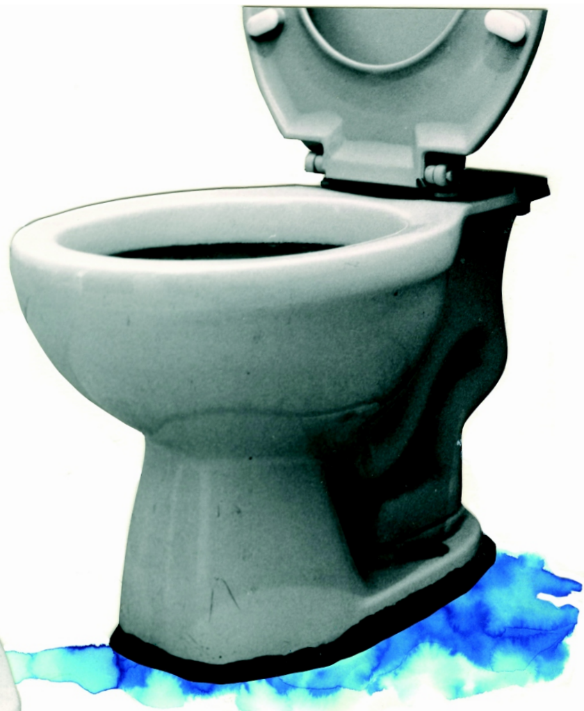
Fuga en la base de la taza
